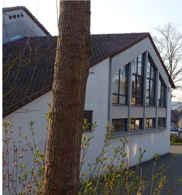
Abb. 4: Westfassade der Mehrzweckhalle mit potentiellen Fledermausquartieren im Traufbereich.
